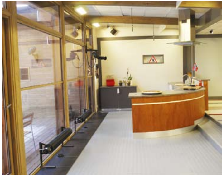
Unter einem Fenster installierte Rippenheizkörper wirken effektiv kalten Luftzügen entgegen, die häufig bei großen Glasflächen auftreten.
